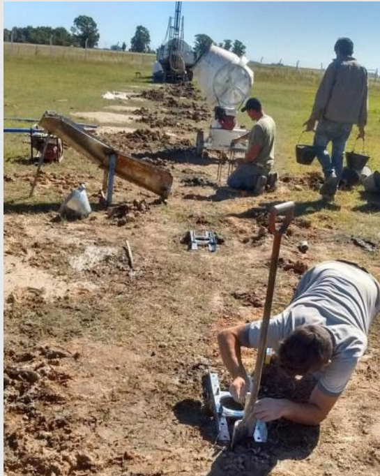
Parque Solar Espigas 200 kW- MEGA
