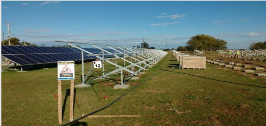
Parque Solar Arribeños 500 kW- Aldar
